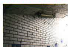
台風15号地下道の天井まで水が入った
